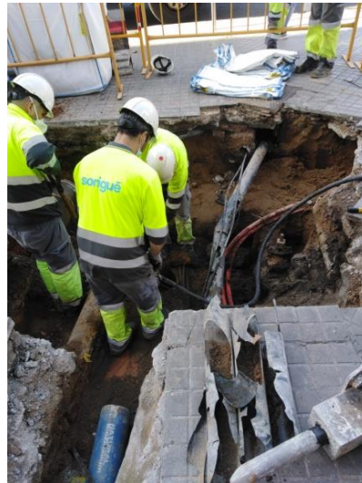
4. Treballs de repicat a la intersecció del carrer dels Tallers i la Plaça de la Universitat
